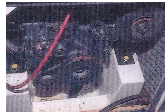
プーリーの溝にサビが生じている。長い間乗らなかった証拠であり、トラブルの原因にもなる
